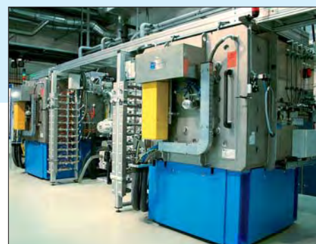
Versuchsanlage in der Halbleiterindustrie
